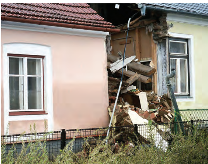
Gebäudeschaden durch Hochwassereinwirkung Hadersdorf am Kamp, Hochwasser 2002
