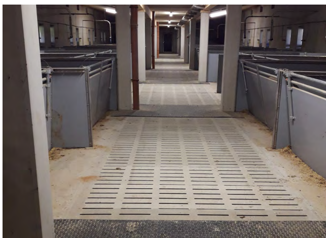
Großzügig dimensionierte Unterflurkanäle nutzen die Kälte im Erdreich als Puffer
