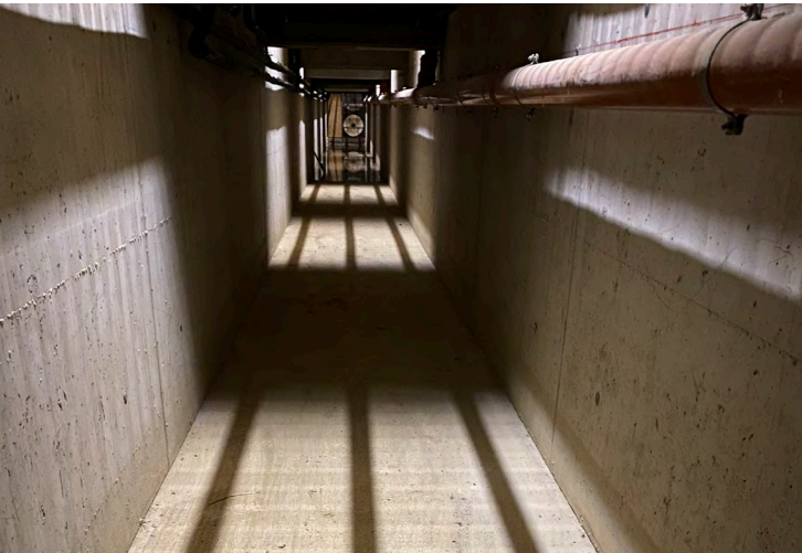
Großzügig dimensionierte Unterflurkanäle nutzen die Kälte im Erdreich als Puffer Foto: E. Zentner
