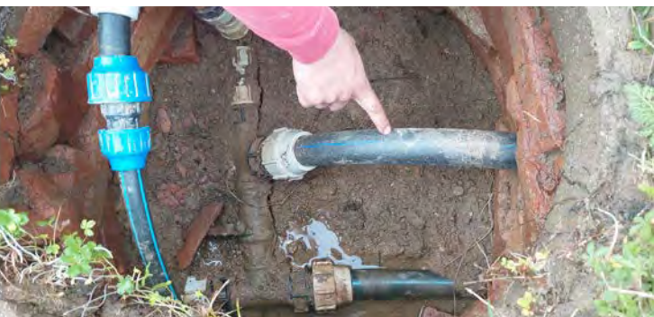
Bei den Verteilerschächten werden die oberirdischen Verteilereinheiten (7 Regnerlanzen mit Schläuchen in Serie verbunden) angeschlossen Foto: A. Pöllinger-Zierler
